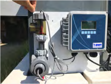
Koeltoren Basisregelaar – beheer van de ontluchting
